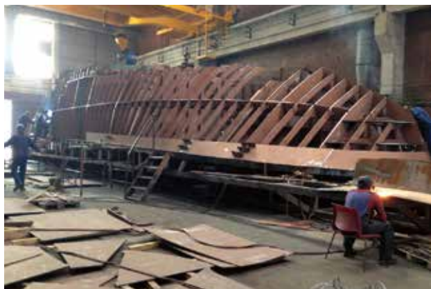
Febril aktivitet under bygget. Svetsgnistor far runt, det luktar bränt och bullrar så mycket att hörselskydd behövs.
