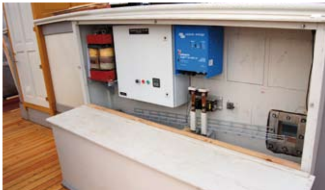
Utrustningen sitter dold i akterkant på förliga däcksbuset. Under bänken i förgrunden ligger en batteribank på 1400 Ah.
